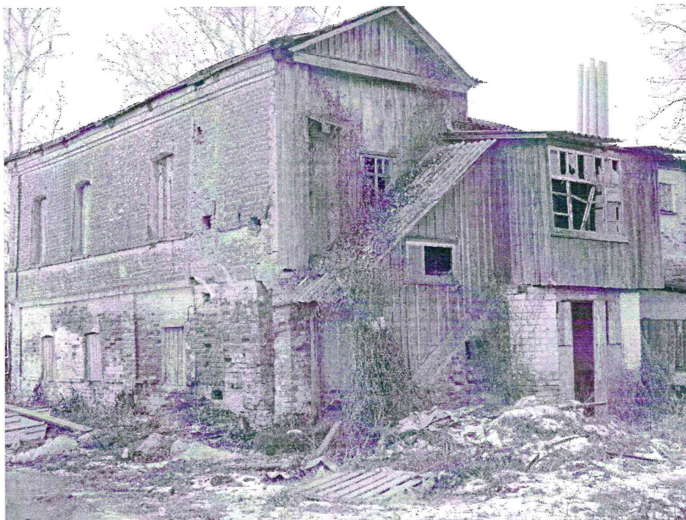
Дворовой фасад. Повреждения: трещины, замокания и биопоражения, отслоения отделочного слоя и частичная утрата кирпичей кладки. Мусор. Поросль.
